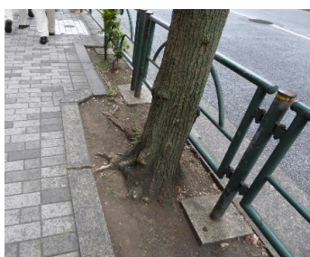
写真 浸透能が低下している街路樹
