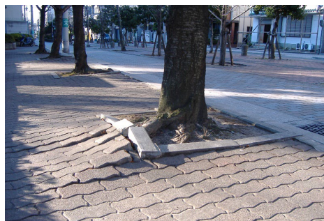
写真 歩道の根上がりで転倒し、訴訟問題になることも
